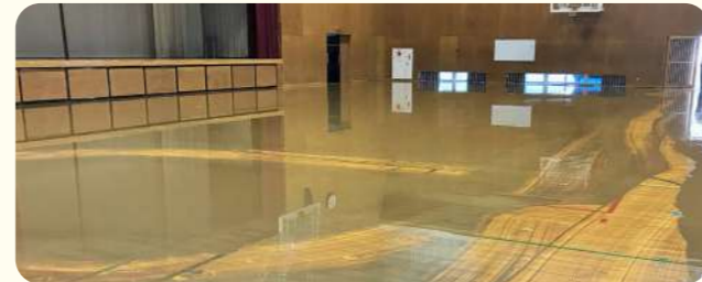
泥が流れ込んだ体育館
